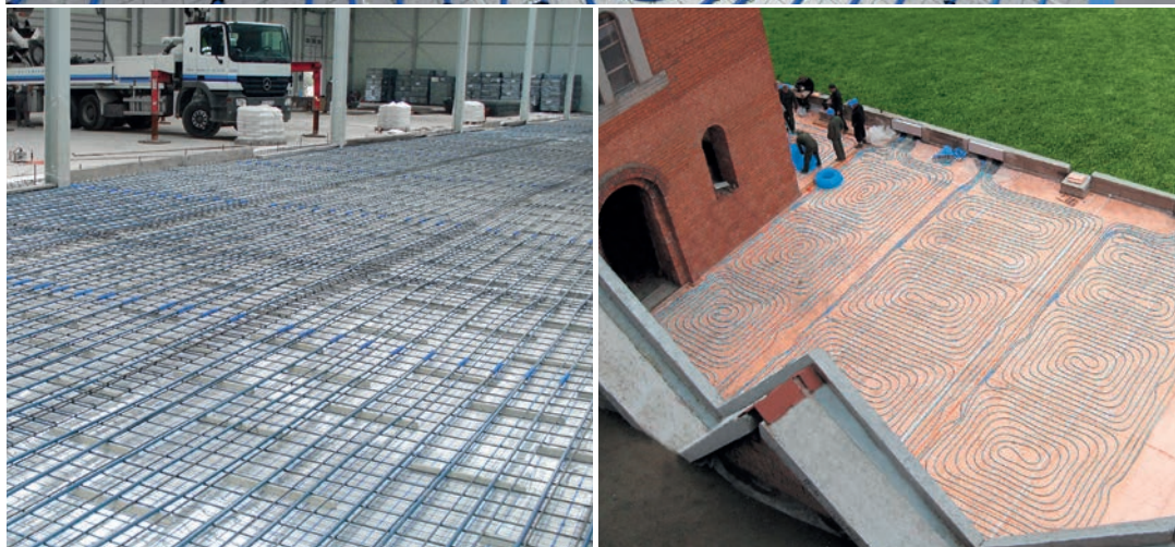
Рис. 4. Система панельного отопления в складском помещении при использовании труб PE-RT Blue Floor и системы KAN-therm NET.
