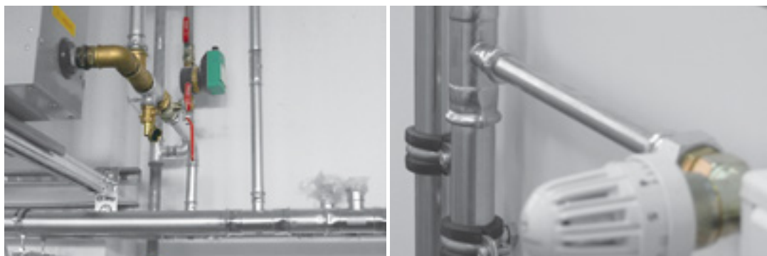
Примеры монтажа оборудования KAN-therm Steel
